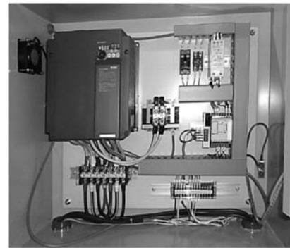
図6 インバータ制御盤の例
