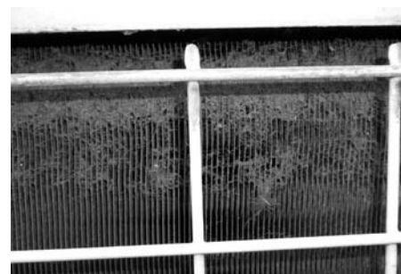
空調室外機の放熱フィンの目詰まり
