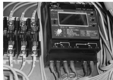
冷凍冷蔵庫のデフロストタイマーの例 専門知識が必要なためメンテナンス業者にお問合せ下さい。
